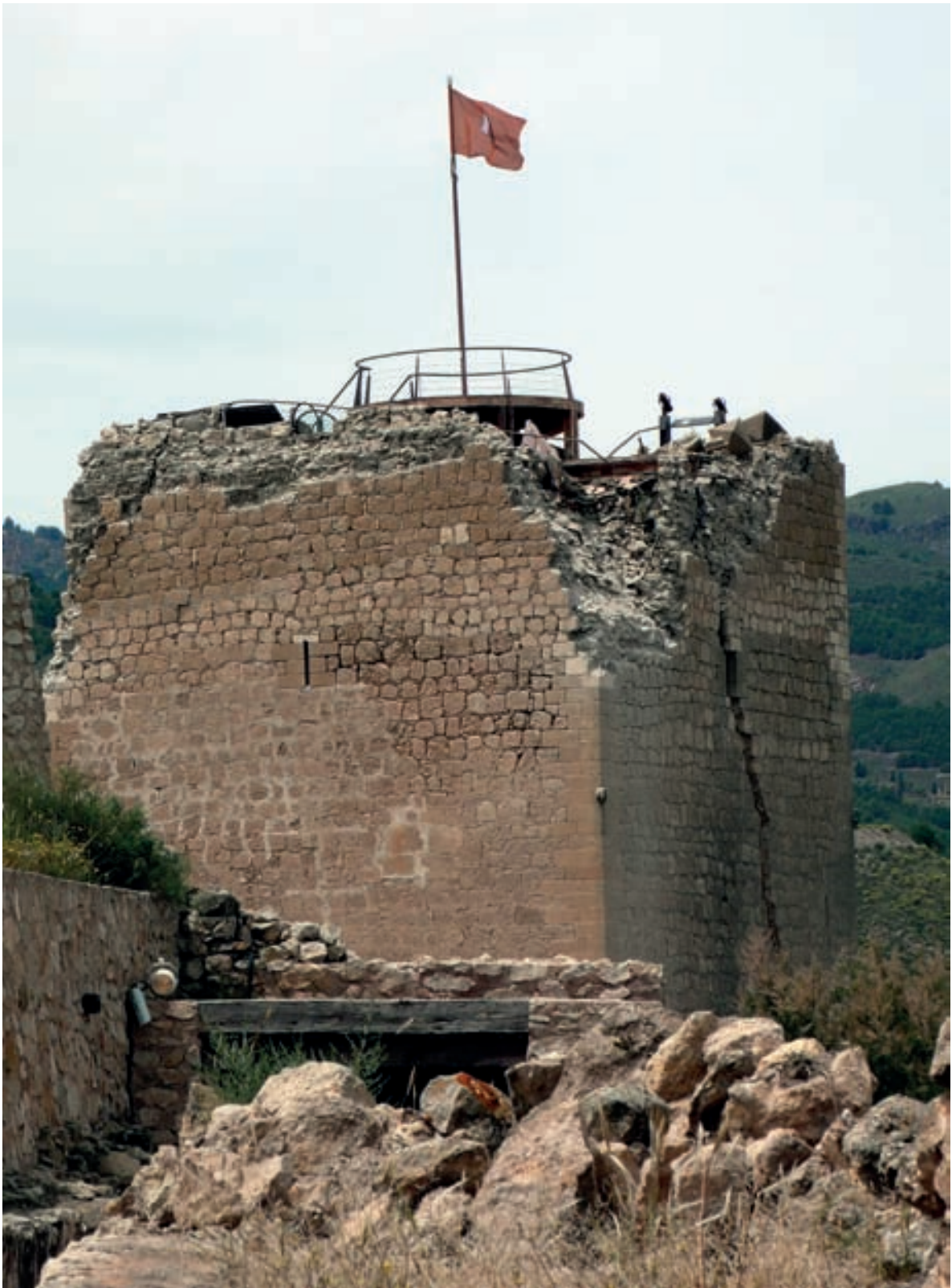
Daños ocasionados por el terremoto de Lorca en la torre del Espolón. Fotografía: Concha Cirujano.
