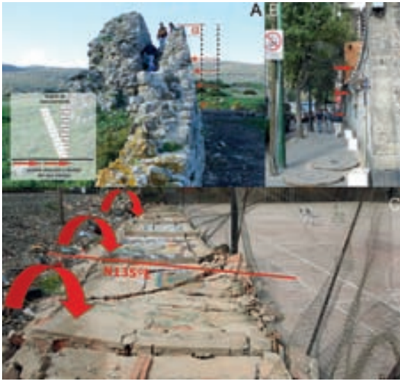
Figura 10. Muros basculados y plegados en: a) muralla defensiva de la ciudad romana de Baelo Claudia (Cádiz, España); b) tapia del patio de la iglesia de San Miguel Arcángel en México DF, estos pliegues fueron generados por el devastador terremoto de Michoacán de 1985 y c) tapia de una pista deportiva colapsada hacia los N135°E junto a la vía férrea de Lorca, producido por el terremoto del 11 de mayo de 2011.
