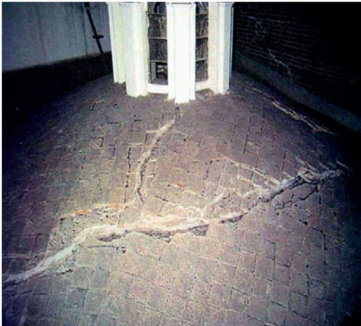
Afectación de la cúpula de la iglesia de la Compañía de Jesús de Quito por el terremoto de marzo de 1987. Fotografía: Distrito Metropolitano de Quito. El Fondo de Salvamento del Patrimonio Cultural (1992-1996).
