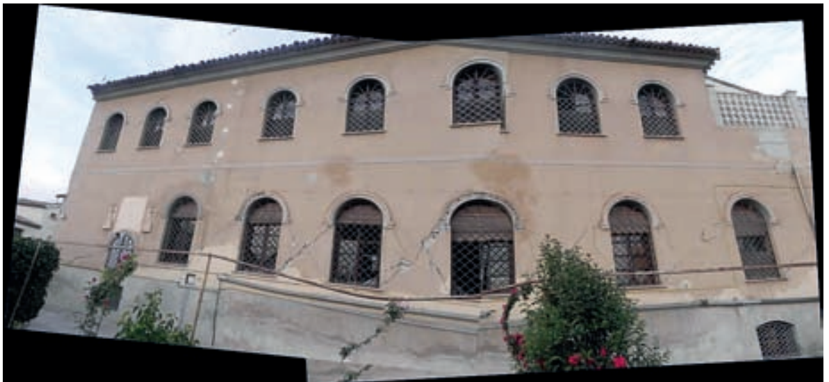
Fotografía 11. Alzado Oeste del Convento de Clarisas, con las habituales grietas en aspa.
