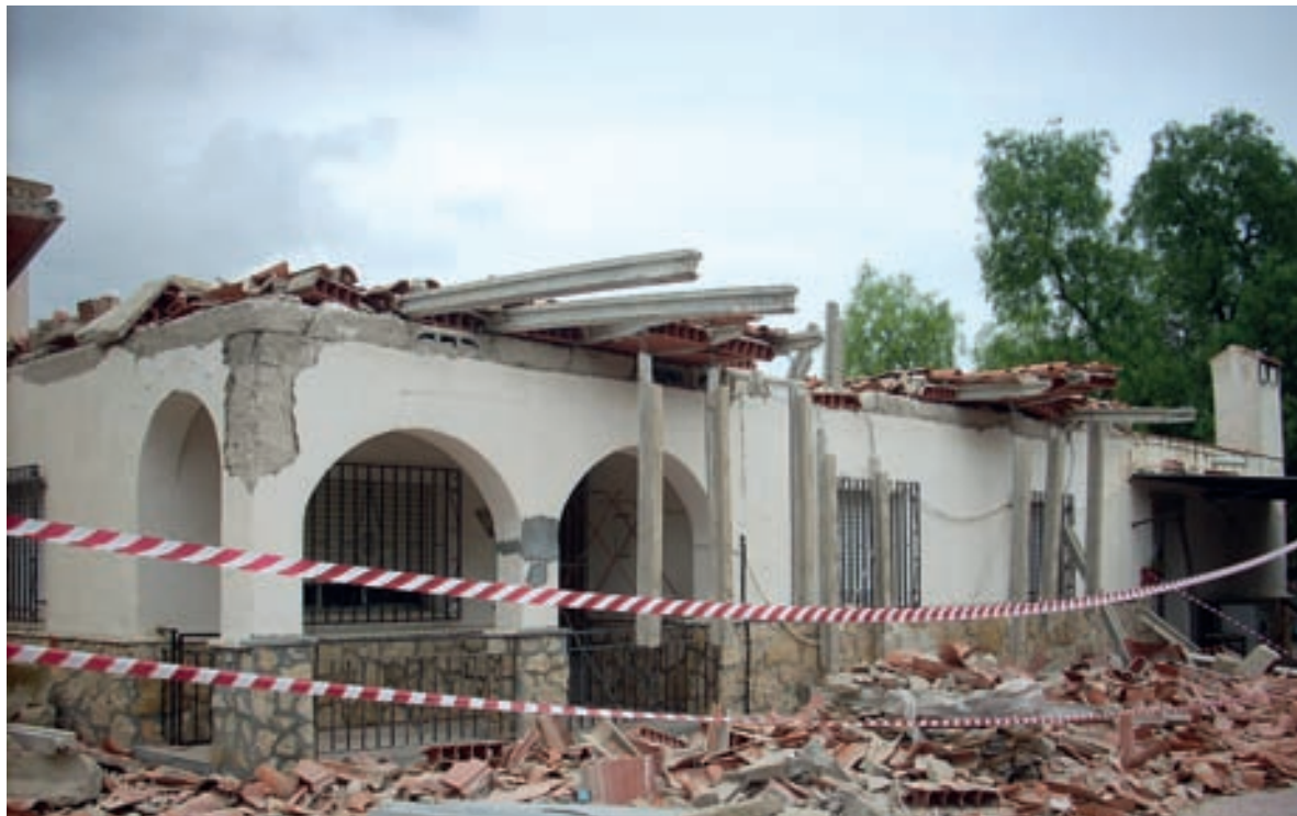
Figura 5. Daños en inmuebles. Colapso parcial de estructuras.
