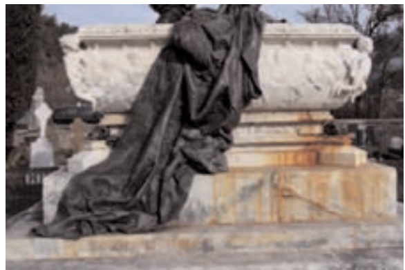
Detalle de la contaminación que se filtra por el desagüe del vaso. Fotografía: In Situ, S.L.
