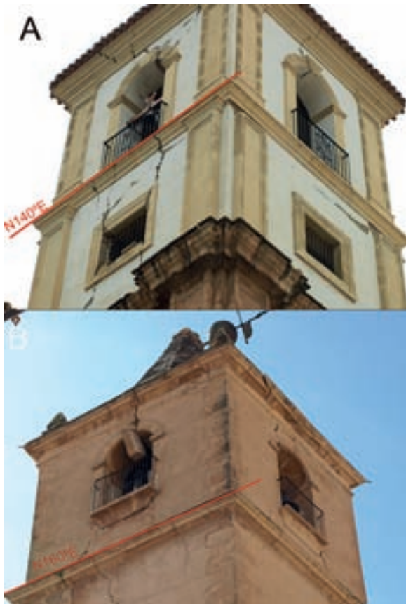
Figura 13. Claves de arco caídas en Lorca como consecuencia del terremoto del 11 de mayo de 2011: a) iglesia de Santiago y b) iglesia de San Francisco.
