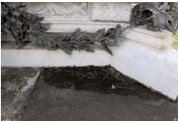
Colonización biológica de las gradas orientadas al NE, retención de agua. Fotografía: In Situ, S.L.
