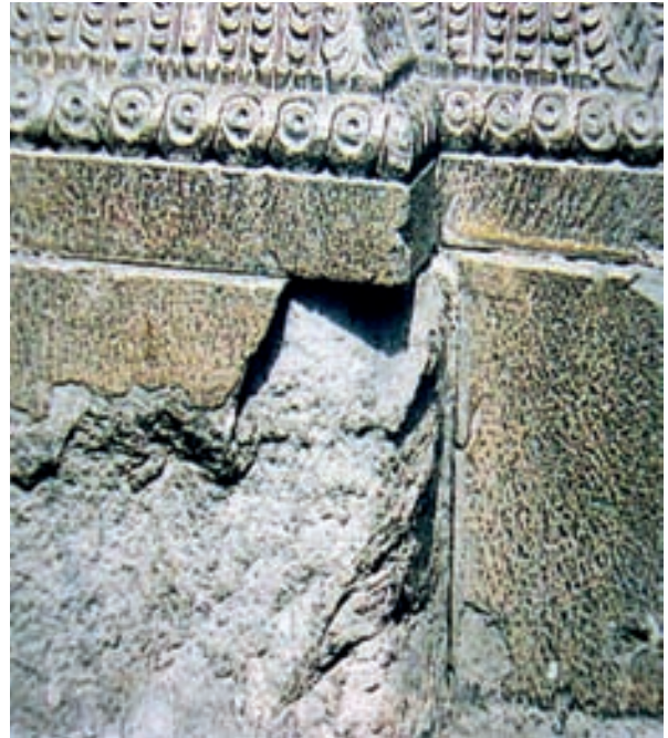
Desgaste de piedra en la fachada de la iglesia de la Compañía de Jesús, Quito. Fotografía: Distrito Metropolitano de Quito. El Fondo de Salvamento del Patrimonio Cultural (1992-1996).
