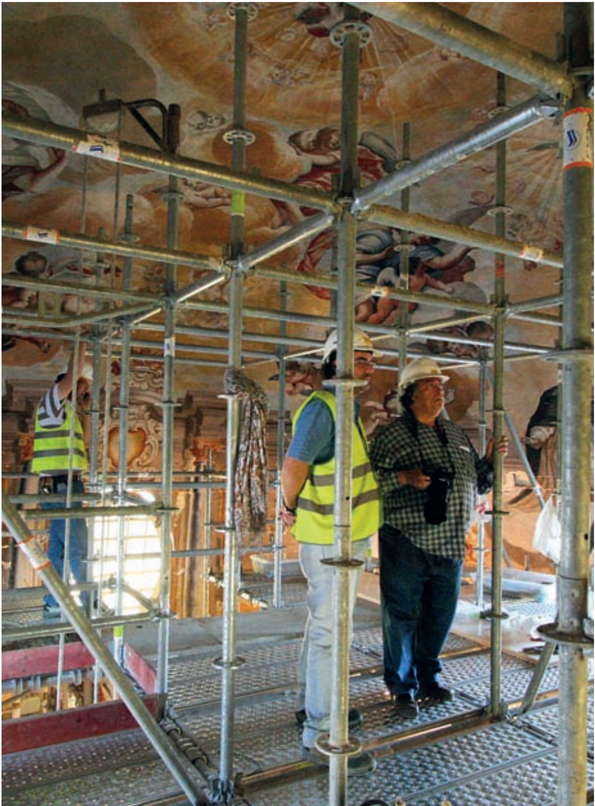
Daños ocasionados por el terremoto en la cúpula de la iglesia de Santo Domingo de Lorca. Fotografía: Carmen Martínez.
