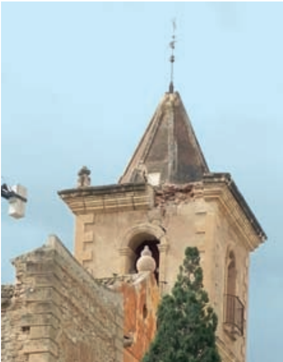
Fotografía 16. Detalle de la torre de San Mateo tras el terremoto, con la caída de parte de los sillares de la cornisa de la torre.
