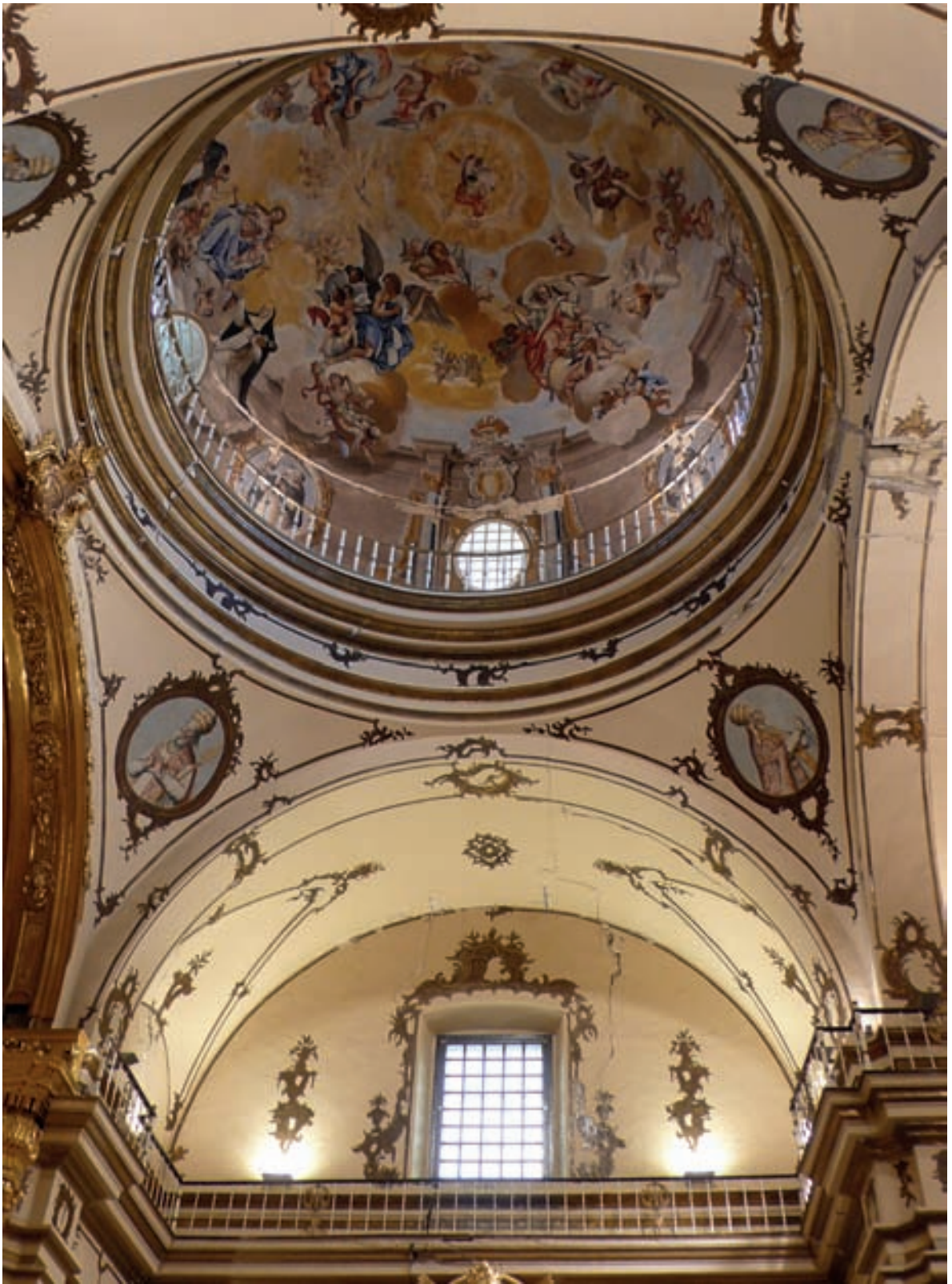
Daños ocasionados por el terremoto en la cúpula de la iglesia de Santo Domingo de Lorca. Fotografía: Concha Cirujano.
