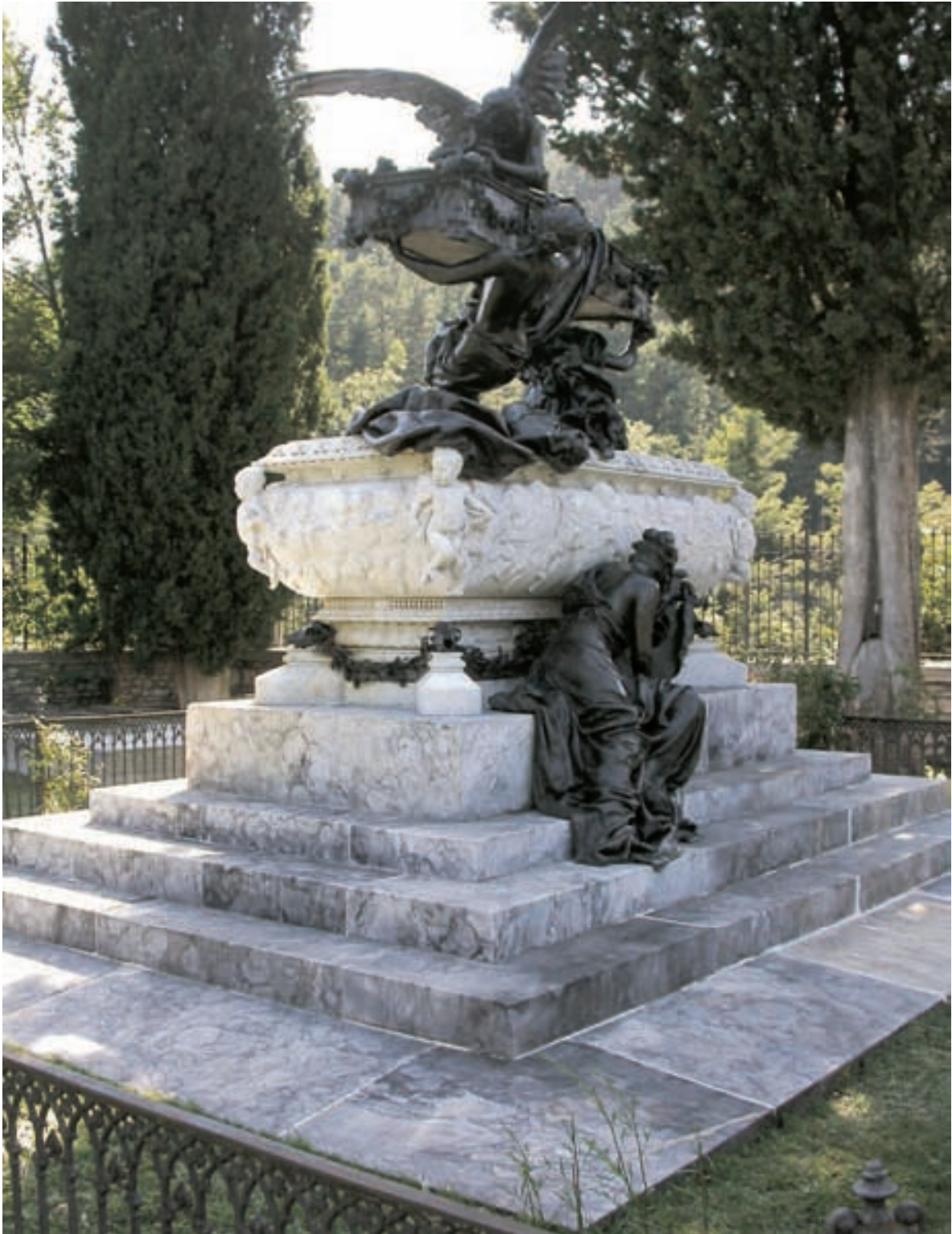
Fotografía final del tratamiento. Obsérvense los rejuntados de grietas con morteros similares a los históricos. Fotografía: In Situ, S.L.
