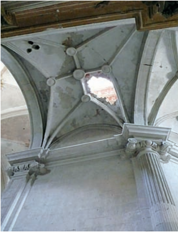
Interior de la Colegiata de San Patricio, con las bóvedas horadadas por la caída de los pináculos de la torre. Fotografía: Concha Cirujano.
