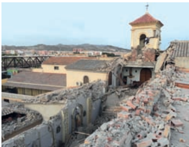
Fotografía 10. Vista de la iglesia de las Clarisas desde la terraza del Convento. Se comprueba que el templo tenía impedido el movimiento hacia el Sur por la existencia del claustro y el consecuente desplome de la coronación del muro Norte que provoca el colapso de la cubierta.
