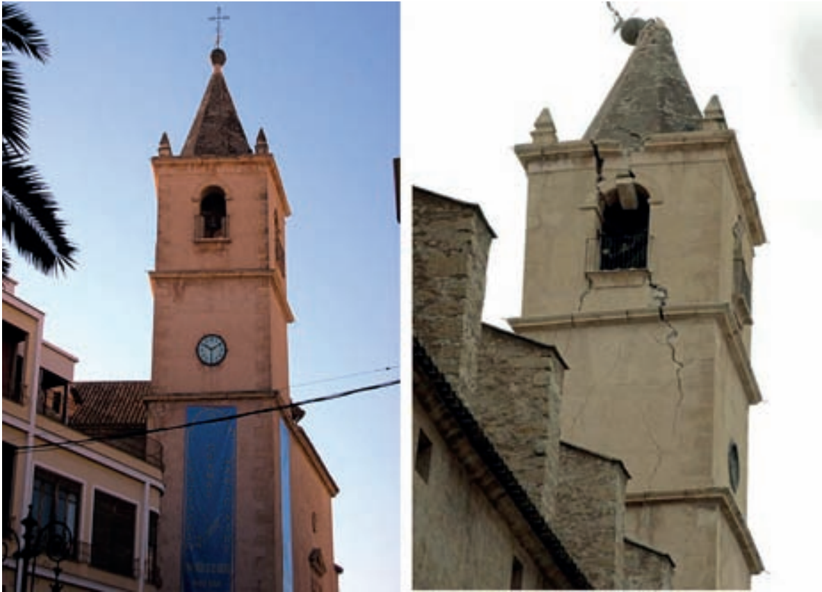
Figura 11. Torre de la iglesia del convento de San Francisco de Lorca, antes y después del seísmo. Fotografías: Comunidad Autónoma de la Región de Murcia y Manuel Muñoz.
