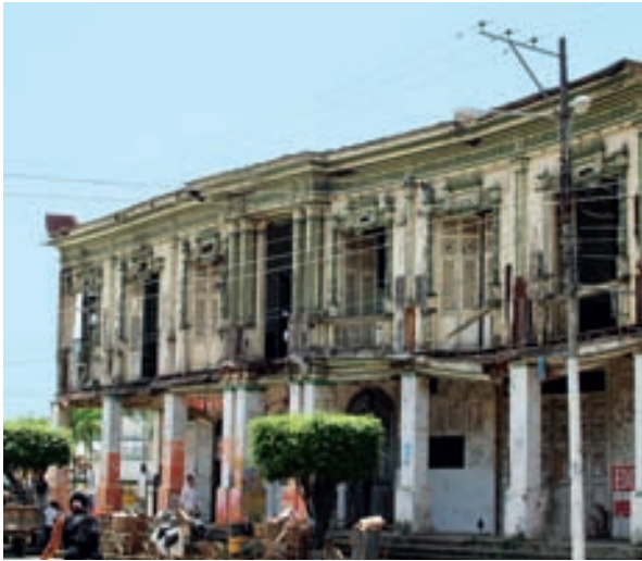
Estado del palacio municipal de Vinces, provincia de Los Ríos, Ecuador. Fotografía: Distrito Metropolitano de Quito. El Fondo de Salvamento del Patrimonio Cultural (1992-1996).
