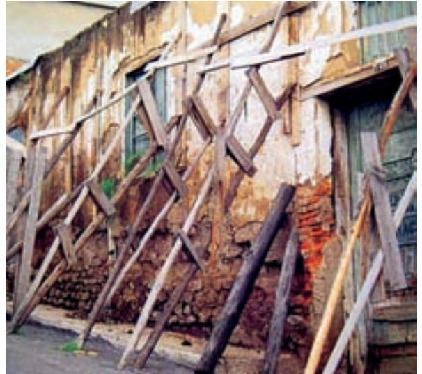
Afectación a la estabilidad de un muro de la escuela Alejandro Cárdenas por falta de mantenimiento. Quito. Fotografía: Distrito Metropolitano de Quito. El Fondo de Salvamento del Patrimonio Cultural (1992-1996).
