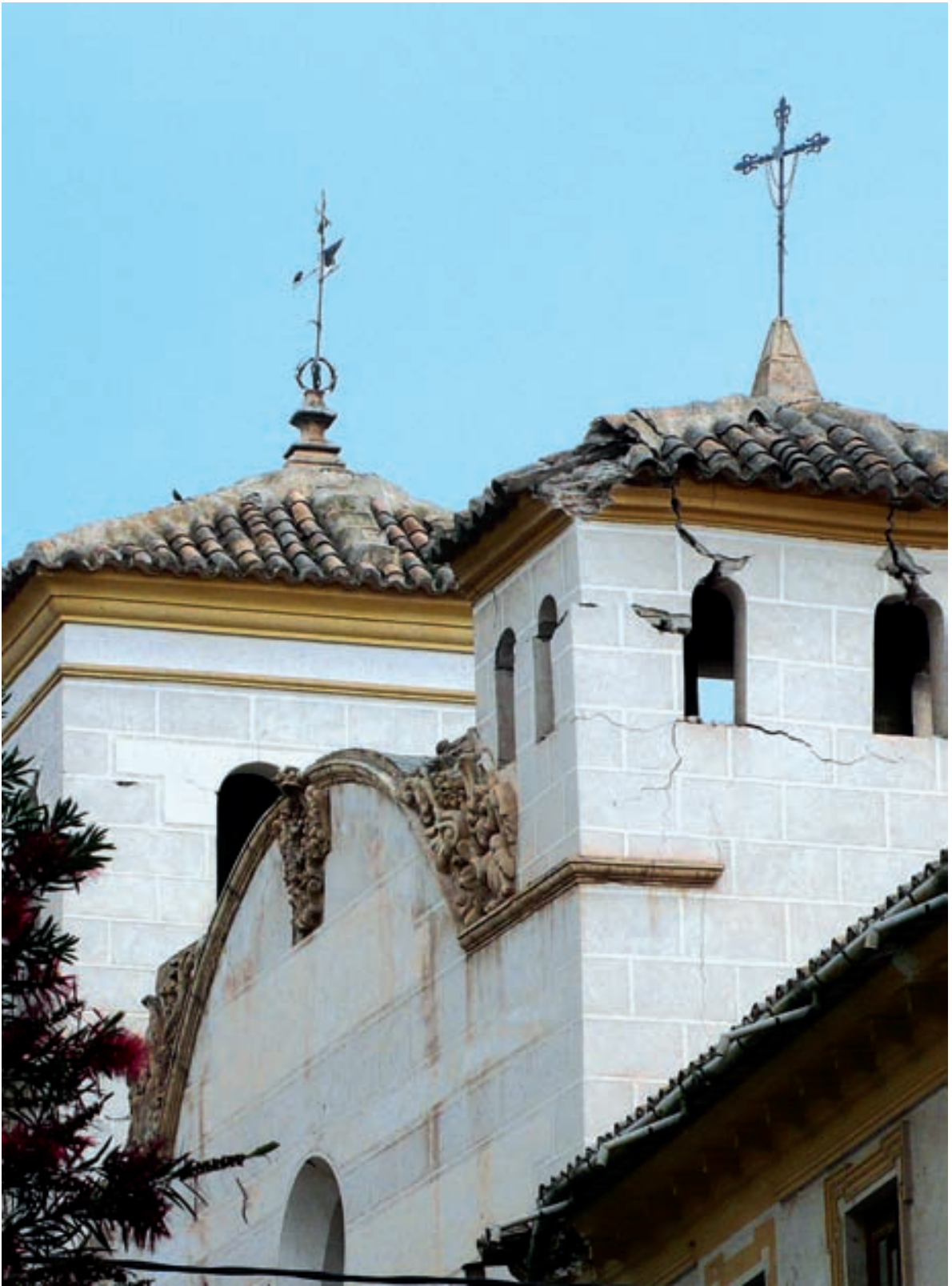
Grietas en la fachada de la iglesia de Santo Domingo de Lorca ocasionadas por el seísmo de 2011. Fotografía: Concha Cirujano.
