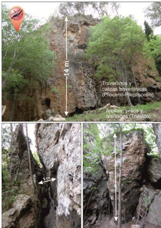
Fig. 25. Imágenes de las grietas de escala decamétrica que afectan al paquete de travertinos y calizas travertínicas en el paraje de La Cabrentá. Este paquete se asienta sobre materiales del Triásico (arcillas, yesos y areniscas).
